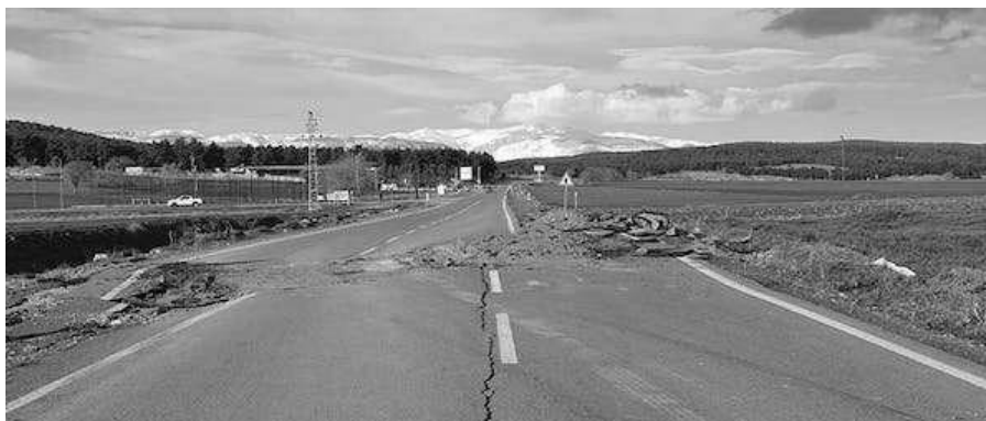
Foto 1. El movimiento de la falla de Turquía, efecto visible sobre la carretera
